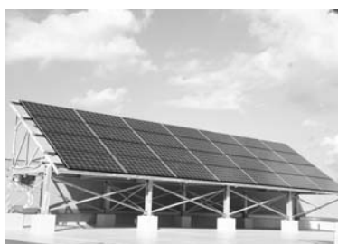
▲太陽光パネルで消費電力をサポート
