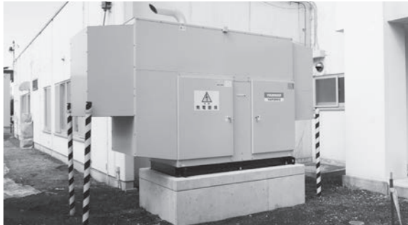
役場総合庁舎に整備された非常用発電機
